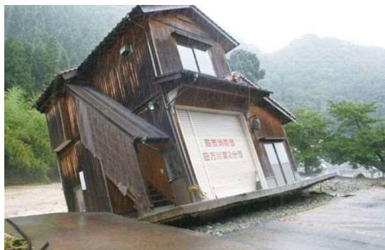
田万川第2器庫の被災状況
