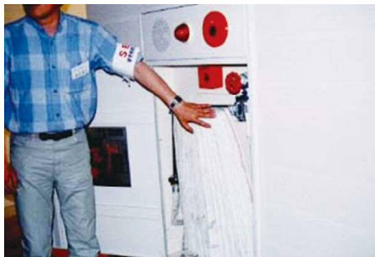
実際に使われた屋内消火栓
